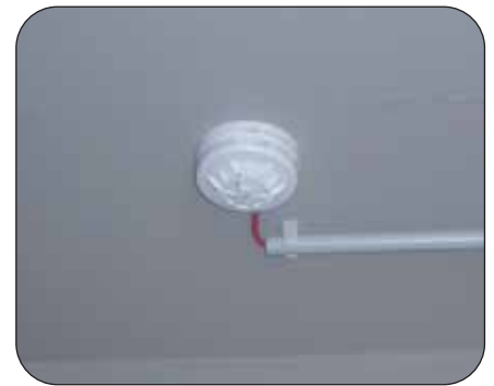
Wärmemelder zur Ansteuerung der Türfeststellanlage
