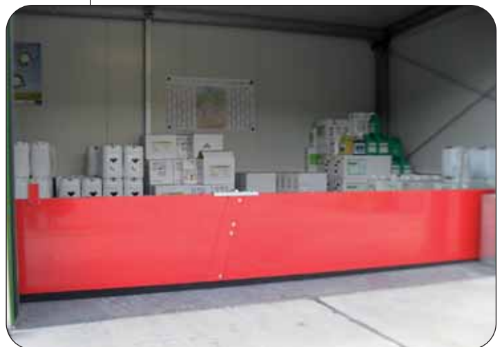
Löschwasserrückhaltung mit dreh-klappbarer Barriere
