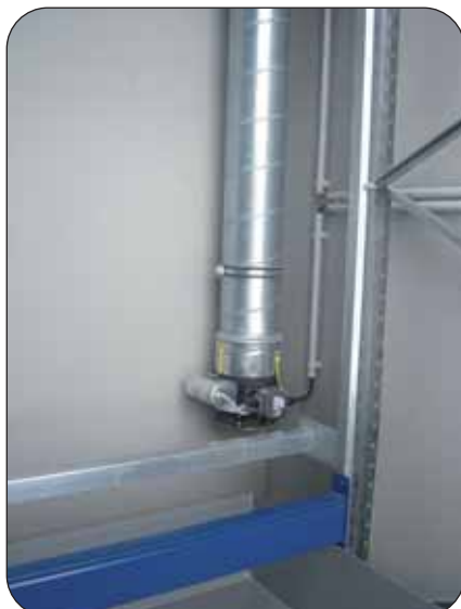
Ex-Abluftanlage inkl. brandgeschützter Lüftungselemente
