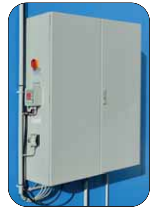
Schaltschrank mit zentraler Steuerung und Bedienelementen
