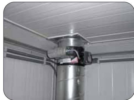
Abluftkanal mit K-90 Absperrvorrichtung
